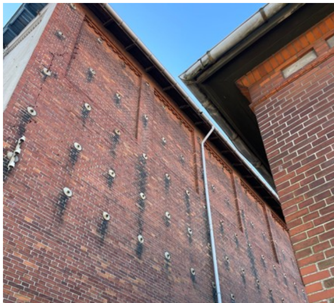
Pakhuset, som indeholder gamle indvendige træsiloeer, er udført med forankring i mange niveauer. Disse forankringer ses som synlige ankre på udvendig side af murværk. Der ses tydelige spor af rustdannelse, som har løbet ned af udvendigt facademurværk.
