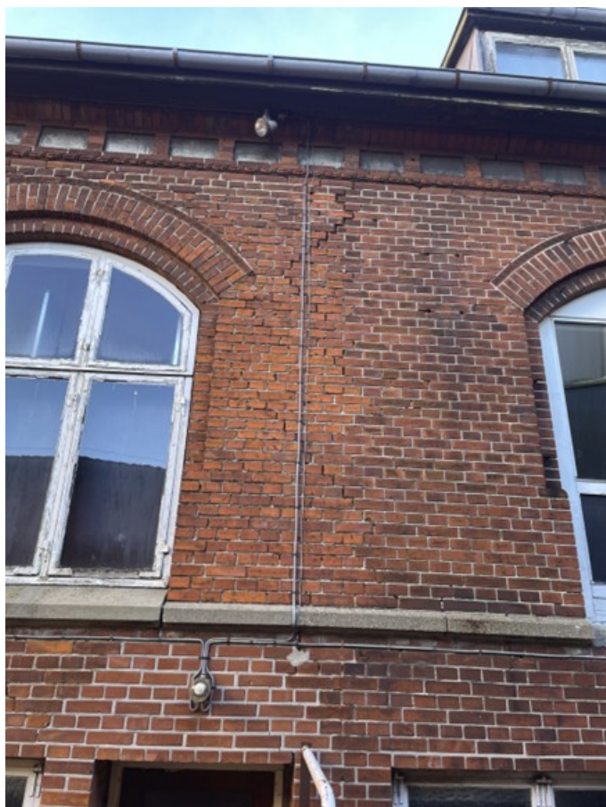
Partielle områder med mangelfulde murværksfuger. Generelt anbefales det at udkradse murværket og omfuge. Der er flere revnedannelser i murværket. Der er ikke mistanke om stabilitets- eller bæreevneproblemer. Indvendigt trænger overflader til renovering og opfriskning. Bygningen har stået tom i mange år og er ikke løbende blevet vedligeholdt og ej heller opvarmet.
